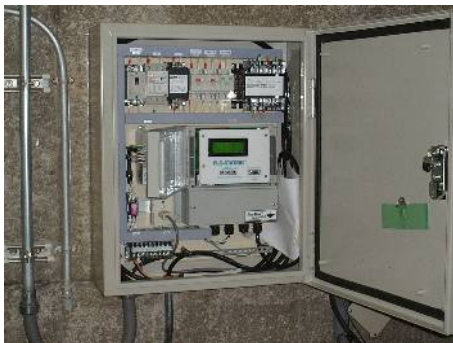
変換器側：盤内に設置
