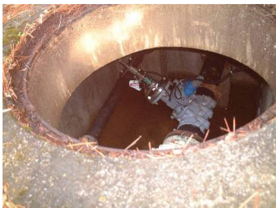
既設ピット内（垂直高さが不足）
