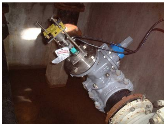
センサを斜めに挿入設置
